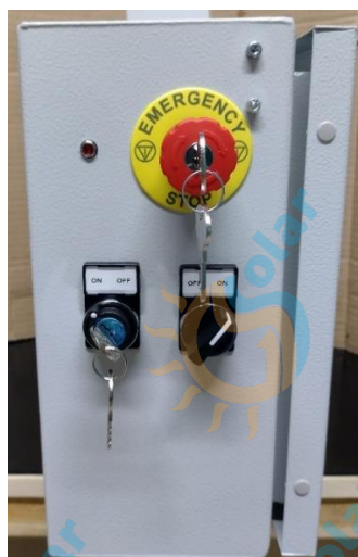
Figura 5.2.1 Vista pulsantiera quadro elettrico
